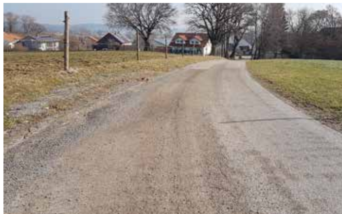
Pleitmannswang: Vor und nach dem Kurvenbereich sind die Schäden an der Augelberg-Strecke am größten
